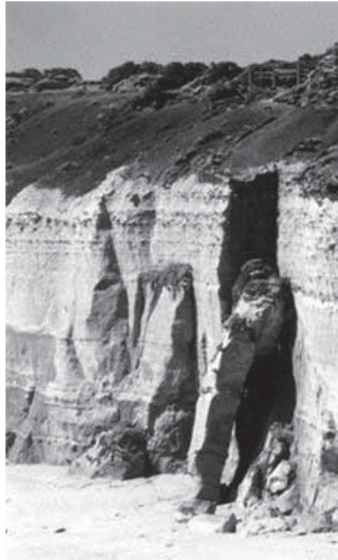
FIGURE 1.19 – Exemple d'effondrement dominé par le cisaillement (Bird (2008)).
