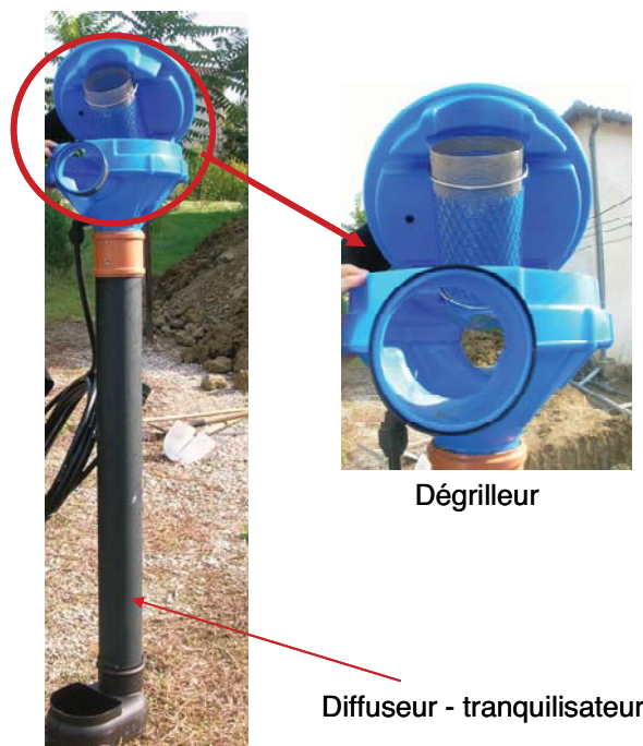
Figure II-13. Tube diffuseur-tranquillisateur et dégrilleur hors cuve sur le site 1
