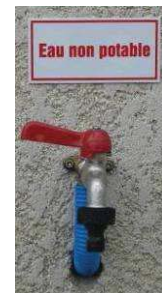
Figure II-18. Robinet extérieur alimenté par la cuve sur le site 1
