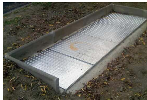
Figure V-8. Bac de comptage sur le site 2
