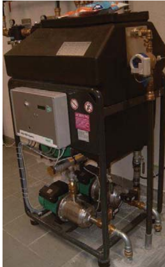
Figure II-32. Système de pompage du site 2
