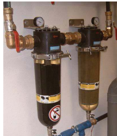
Figure II-33. Système de filtration du site 2
