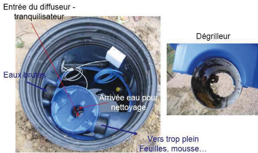
Figure II-12. Tube diffuseur-tranquillisateur et dégrilleur en cuve sur le site 1
