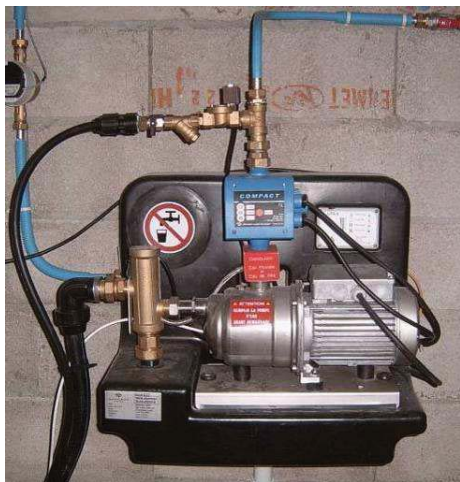
Figure II-15. Système de pompage du site 1
