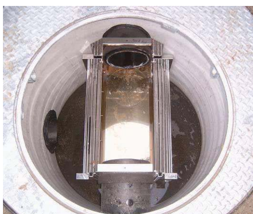
Figure II-29. Dégrilleur du site 2
