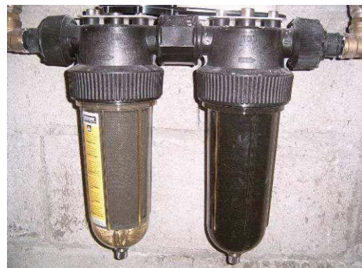
Figure II-16. Système de filtration du site 1
