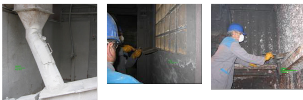
Filter process four où est localisé le refus des manches filtrantes des cheminées. Poussières prélevées sur les bords des fenêtres, atelier four. Dépôt prélevé sur une poutrelle, atelier affinage.
