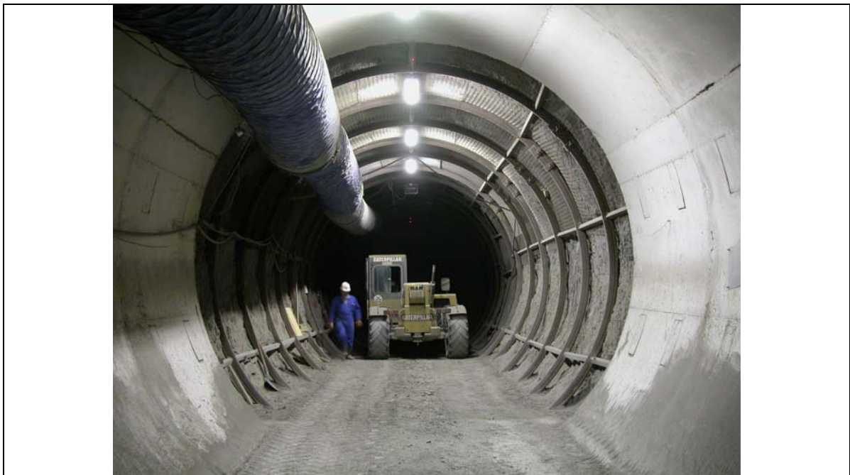
Figure 91: Creusement de la galerie principale de 2003 montrant le tronçon bétonné et celui avec cintres métalliques et grillage en voûte.
