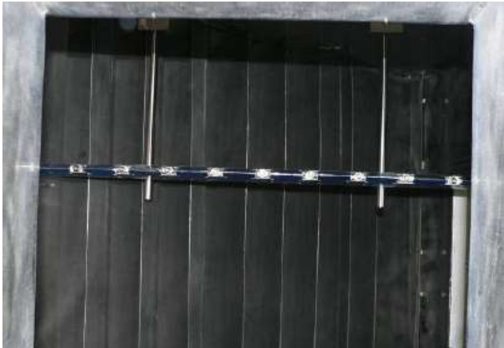
Figure 11: Rampe de gicleurs à l'entrée de la section.
