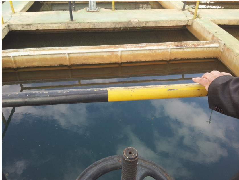
Floculador y sedimentador.
