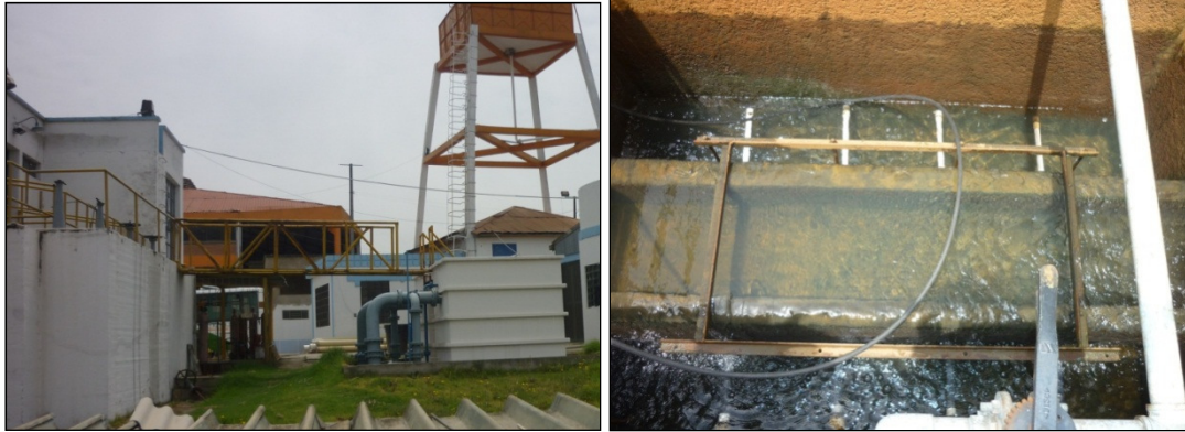
Figura 7-7. Tanques de Filtración.
