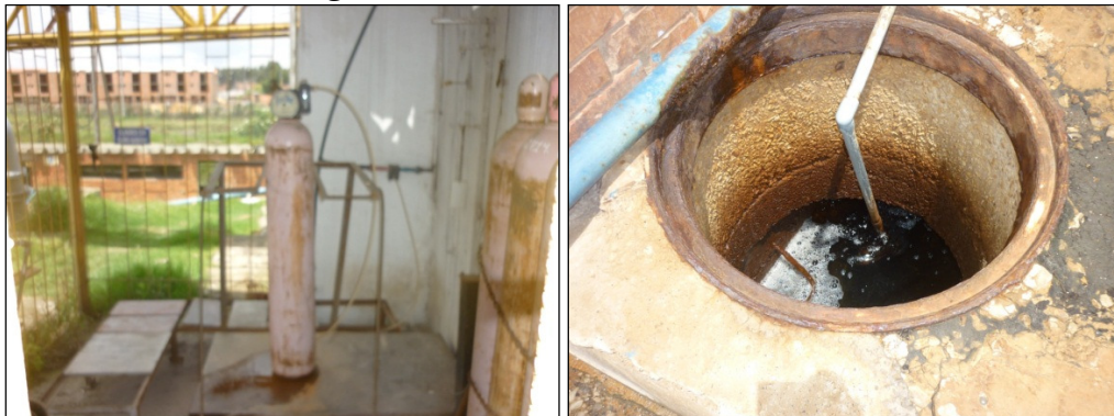
Figura 7-8. Unidad de Cloración.
