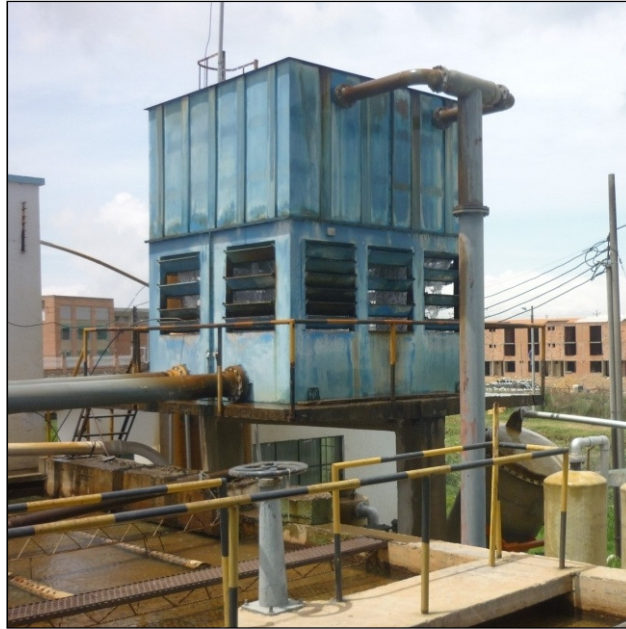
Figura 7-3. Tanque de aireación.
