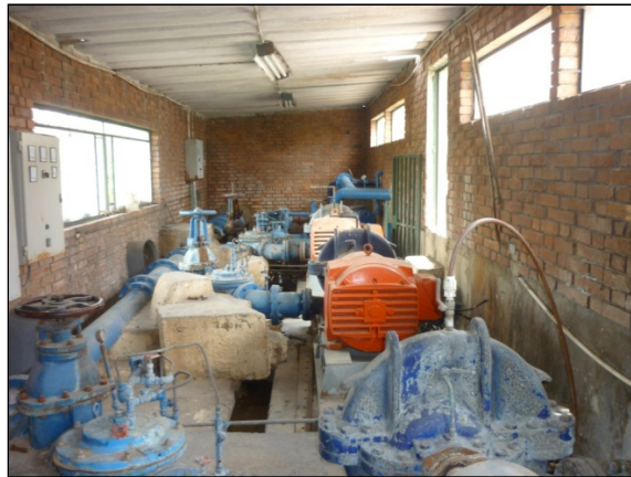
Figura 7-9. Caseta de Bombas.
