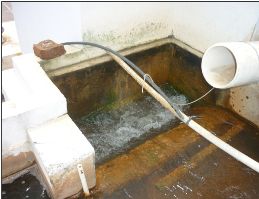
Figura 7-4. Tanque de mezcla rápida y adición de sulfato de aluminio.
