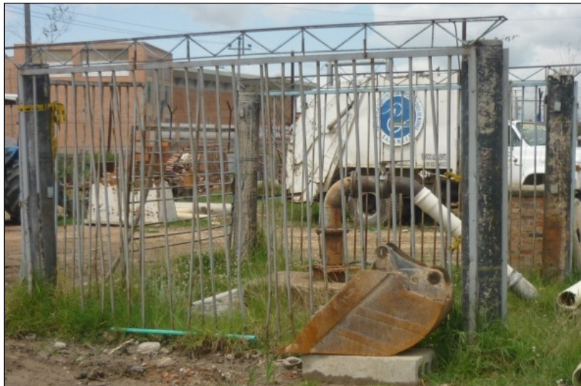
Figura 7-2. Pozo profundo de Agua Subterránea “Pozo 7”.
