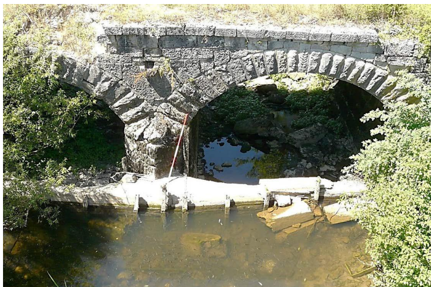
Slika 3. Pregrada na potoku Sušik
