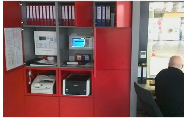
Bild 23: Auch komplexe Technik ist heute miniaturisiert: Brandmeldezentrale im Geb. A für den gesamten Nordcampus
