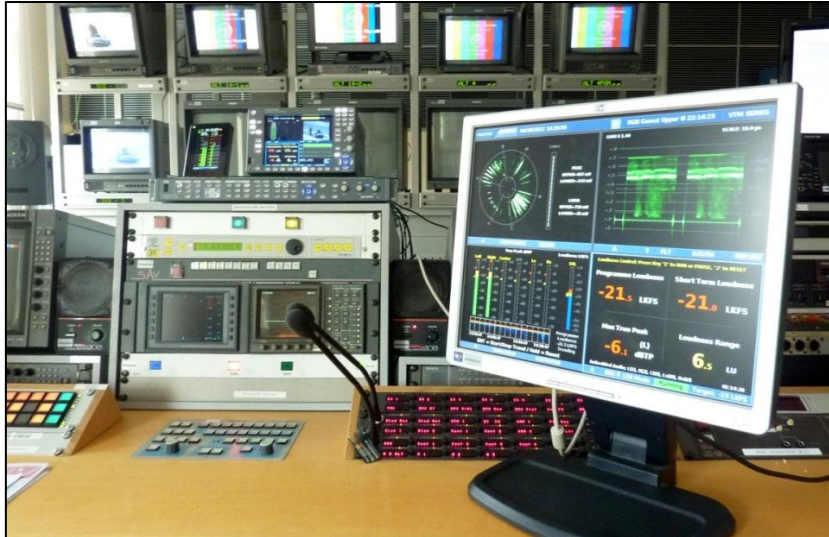
Abbildung 27: Teststellung im Schaltraum des Landesfunkhauses Dresden
