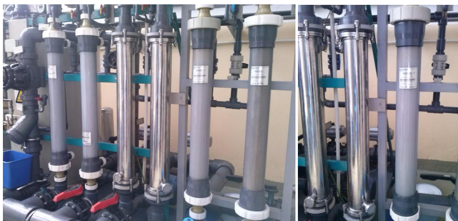
Slika 21: Ultrafiltracijski moduli – 4 polimerni in 2 keramična modula
