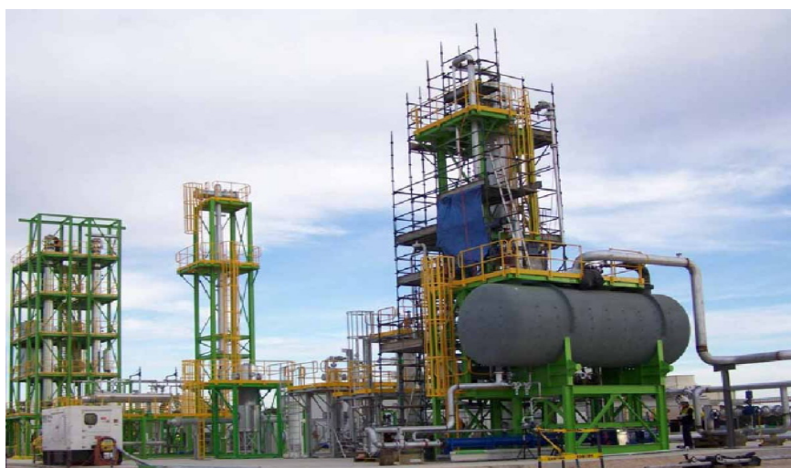
Рисунок 1.21 – Станція СПГВ Шиншила
