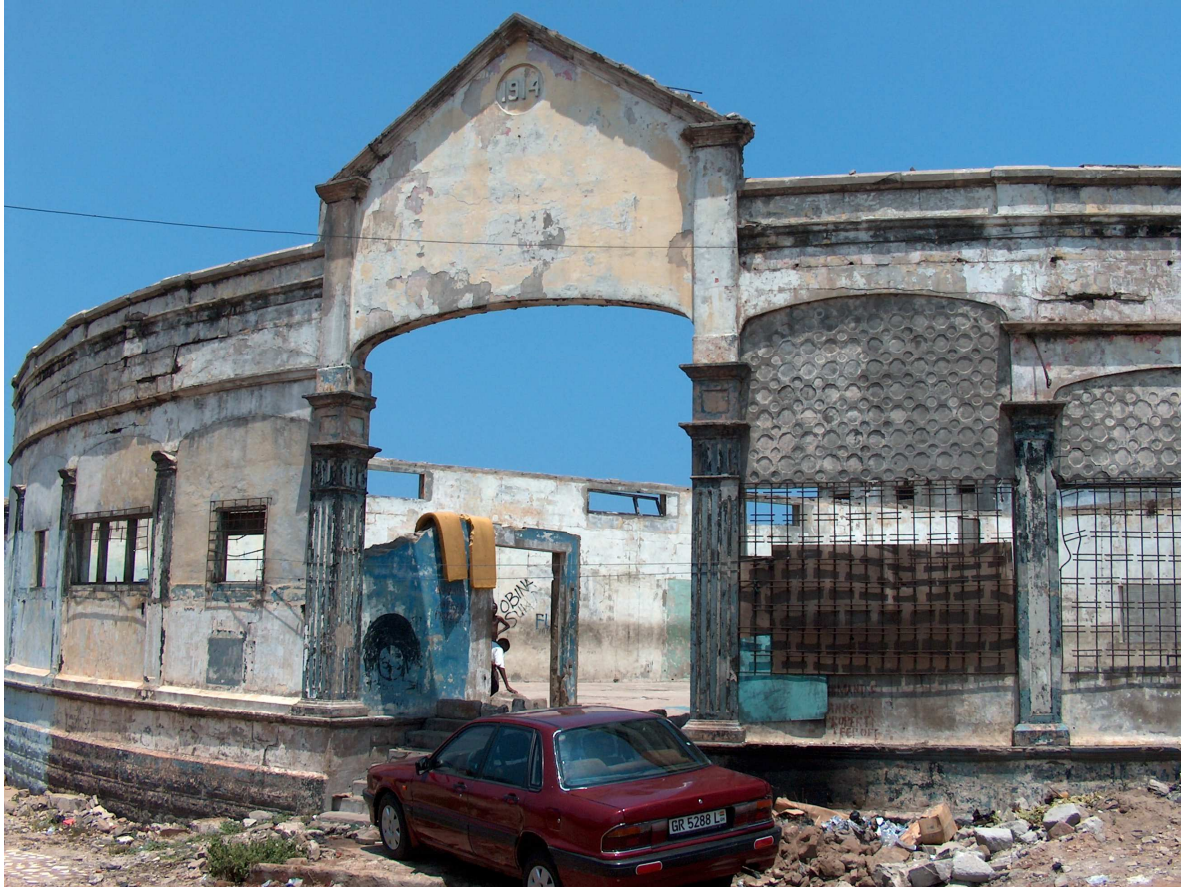
Abbildung 6 [Foto eines nicht mehr benutzten Gebäudes mit Jahreszahl in James Town ©K.R.]
