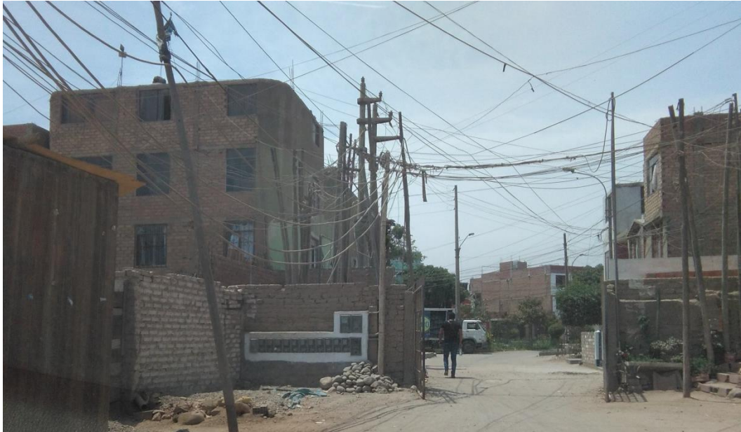
Imagen 83: Conexión eléctrica clandestina
