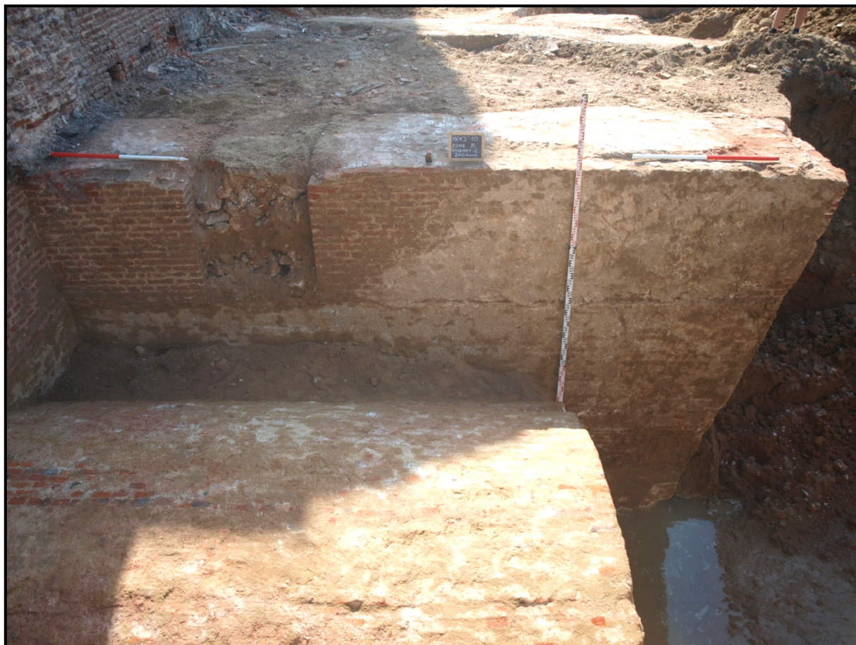
Figuur 25: Zijaanzicht op de flank van kazemat 2, met de volgestorte doorgang, de schuine bepleistering en de schuin aflopende achterzijde.
