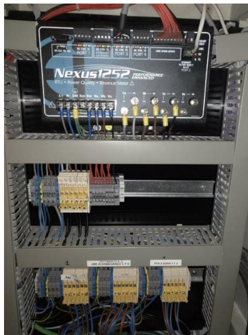
Figura 15: Equipo Nexus 1252 instalado en el edificio Severo Ochoa
