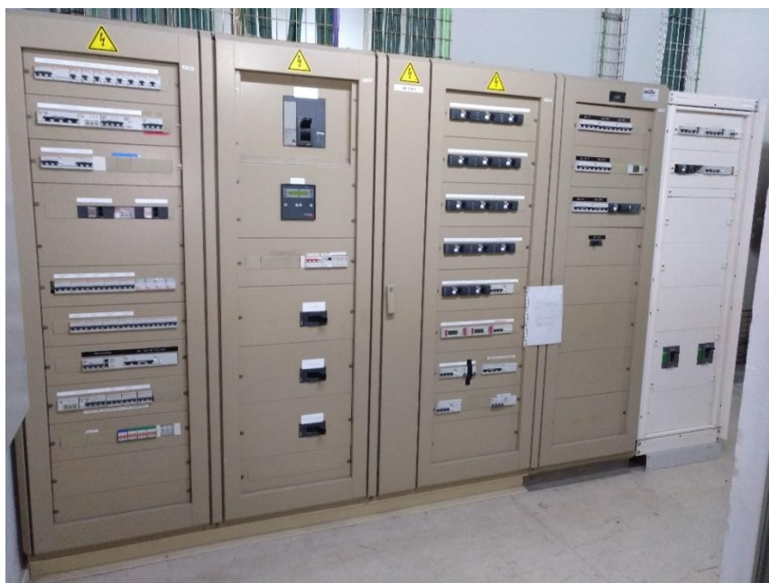
Figura 7: Cuadro general de baja tensión del edificio Severo Ochoa
