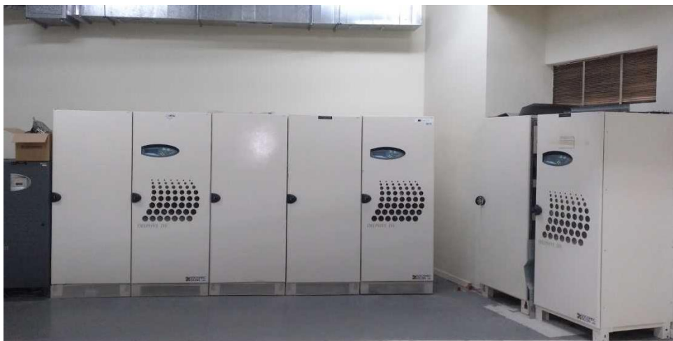
Figura 10: Sala de SAI de los Servicios Científico Técnico.
