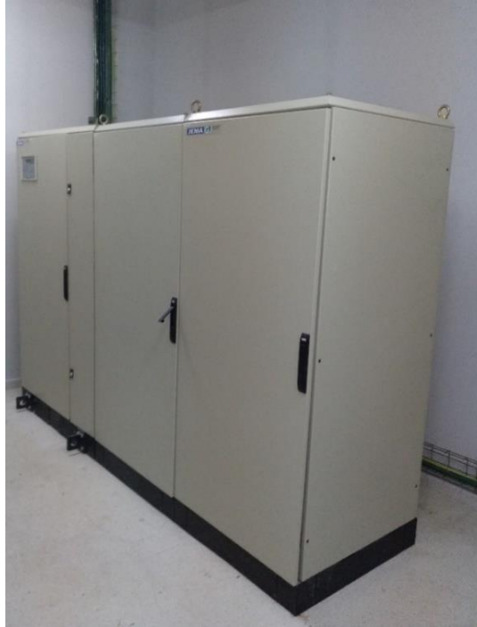
Figura 9: Imagen del SAI general del edificio
