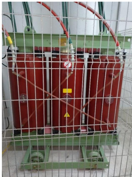
Figura 5: Transformador seco 1250 kVA
