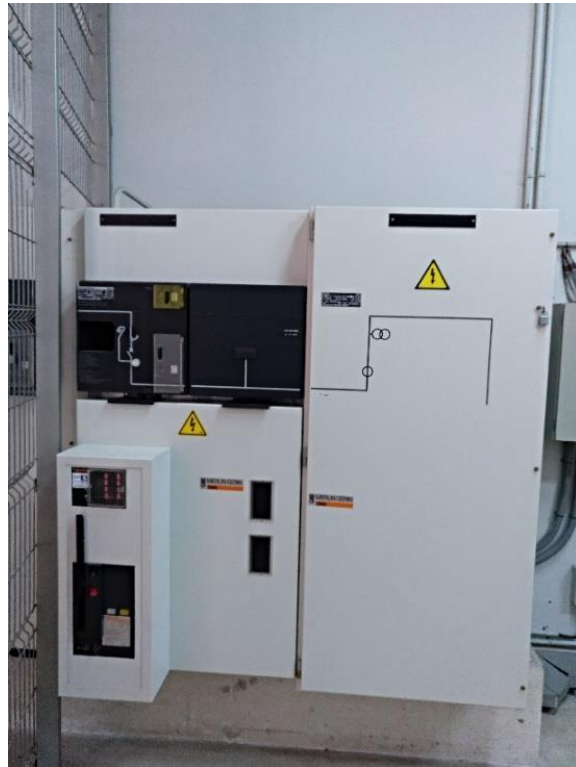
Figura 4: Celdas de corte y medida del centro de transformación
