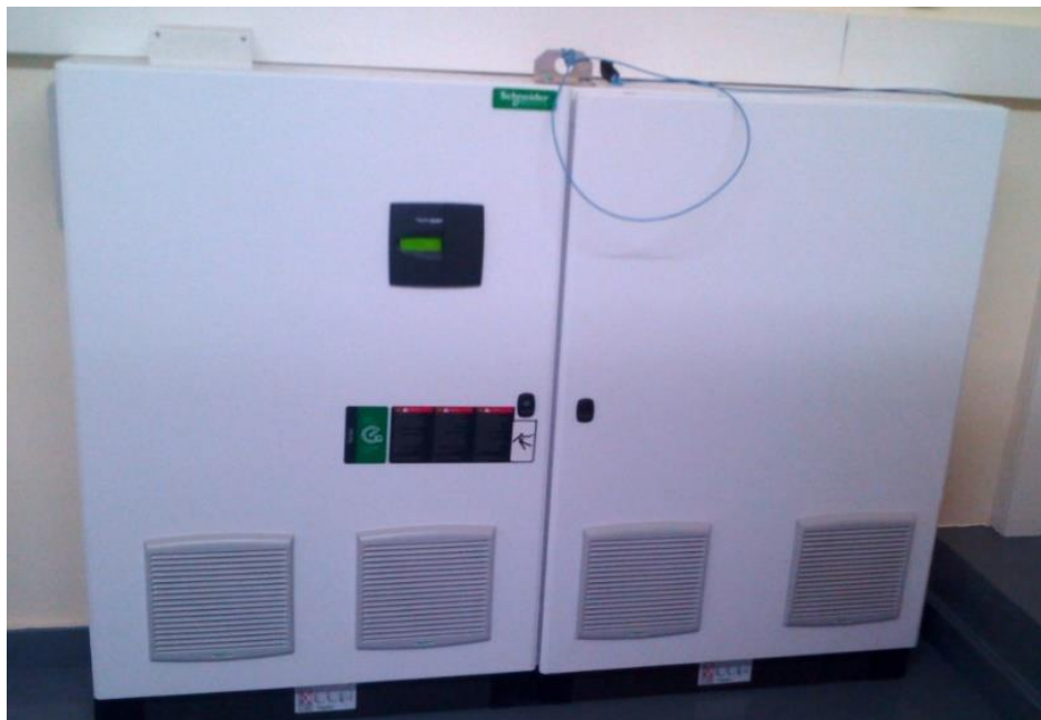
Figura 11: Batería de condensadores instalada en el edificio.
