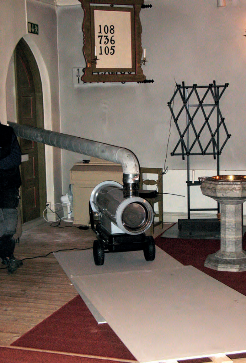
Bild 6. Det vita värmeaggregatet var en testkanon som visade sig vara för klen. Dessutom fick frånluften dras utanför kyrkan. Då föddes idén att placera hela aggregatet utanför kyrkan istället. Foto: Thomas Engel.
