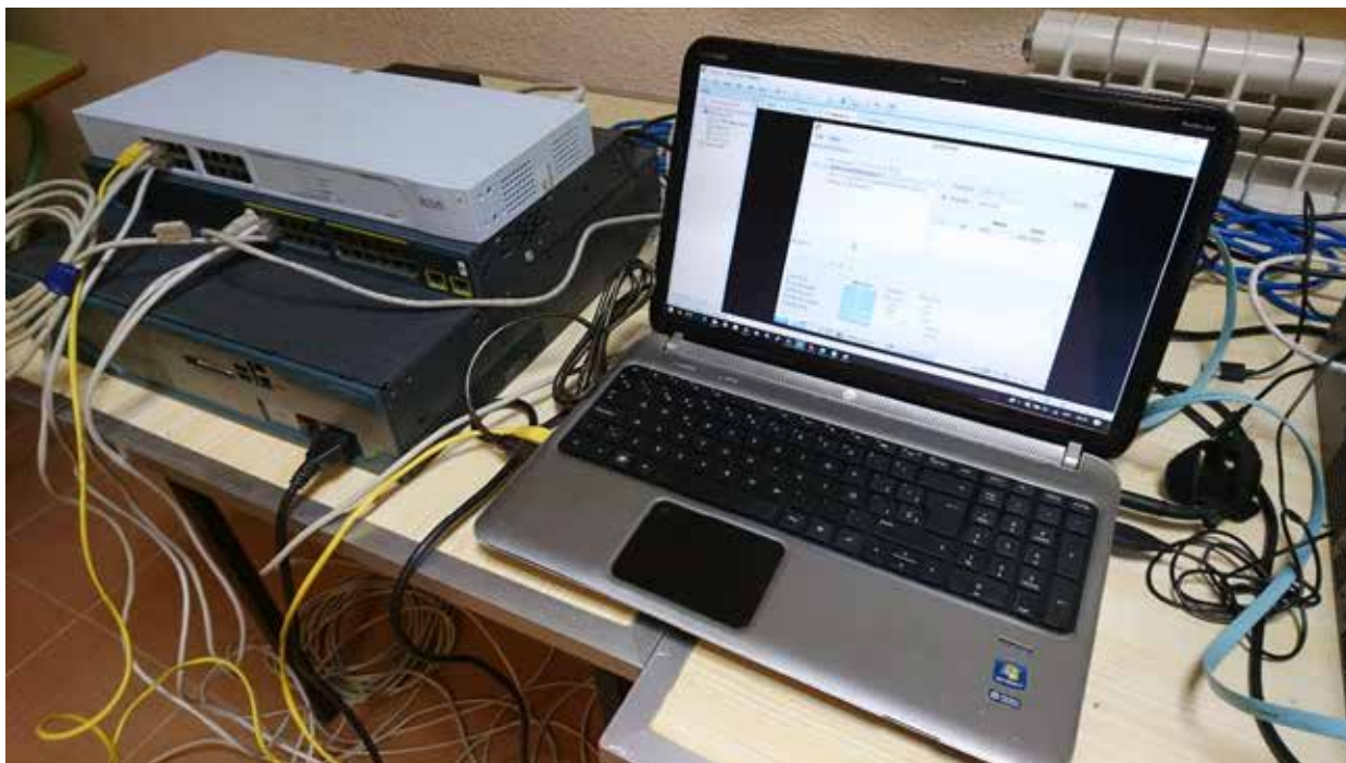
Montaje de pruebas Cisco
