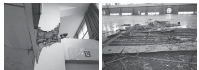
c. 柱の損壊
