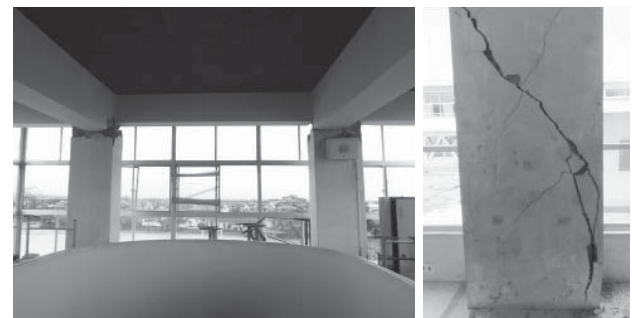
a. 柱と窓枠損傷
