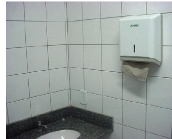
Fig 1: Instalações sanitárias com avisos de procedimentos de higienização das mãos.
