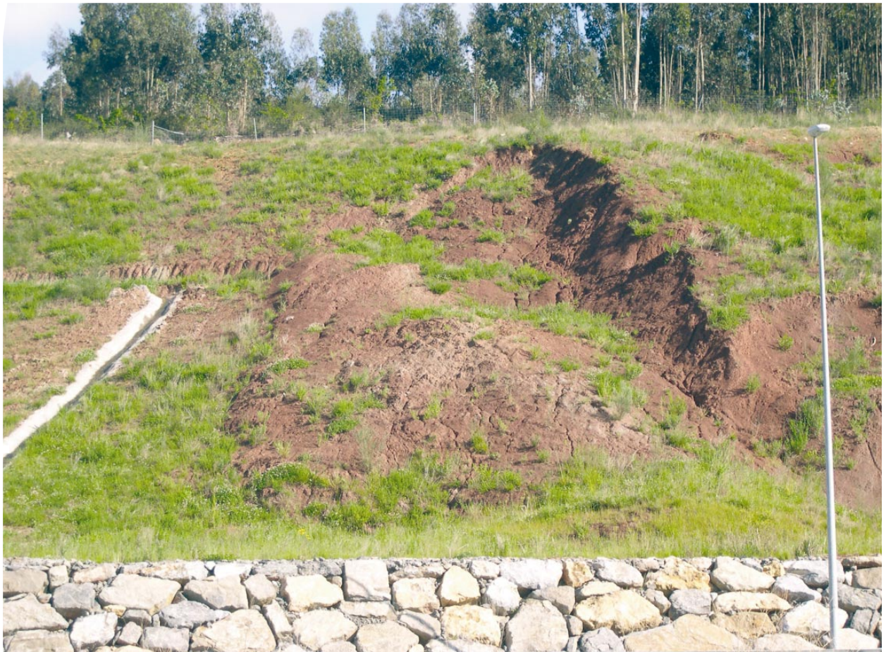
Figura 7. Deslizamiento reciente en las proximidades del entronque de la Autovía A-64 y la A-8, donde se aprecian la masa desplazada y la cicatriz erosiva.
