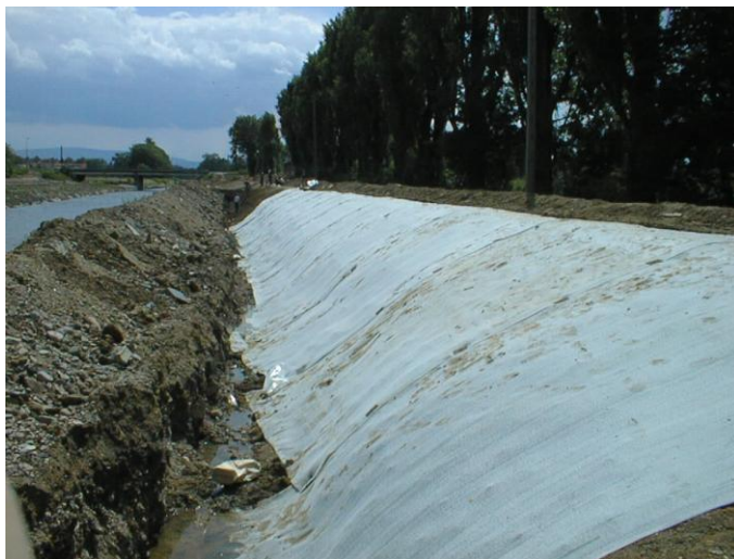
Fot. 2. Jedno z pierwszych zastosowań w Polsce maty bentonitowej do uszczelnienia wału przeciwpowodziowego
