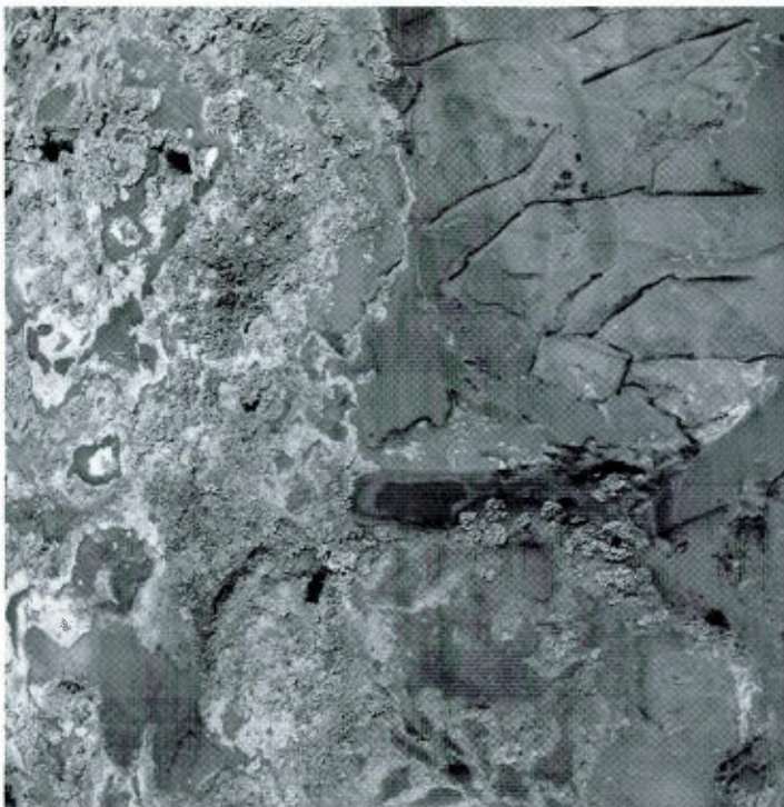
Fig. 201 La composante de plâtre (minéralité) de la matière a permis l'ancrage du lichen (la fausse pierre a réagit comme de la vraie pierre). Le pattern des « fissures » situé en haut à droite résulte de vraies fissures « rehaussées » par une abrasion à la pointe rotative réalisée quelques années après l'installation.
