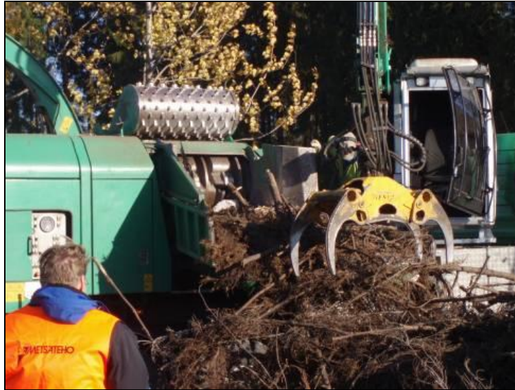
Kuva 25. Hakkuutähteen joukossa ollut kivi on tukkinut hakettimen syöttöjärjestelmän. Hakkuri on pysäytetty tukkeuman selvittämisen ajaksi (kuva M. Ruokolainen).
