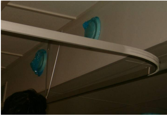
Kuva 8. Riittävän ilmanvirtauksen takia, osa poistoilmaventtiileistä peitetään puhdistuksen ajaksi.
