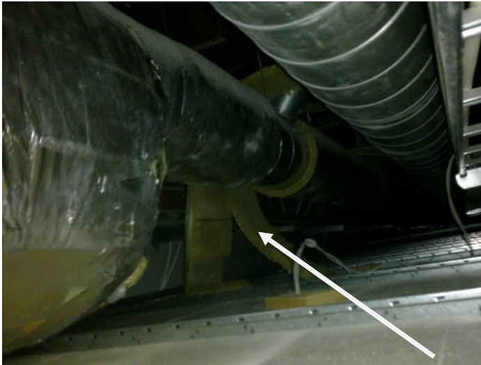
Kuva 16. Tuloilmakanavasta irtoavat eristeet.
