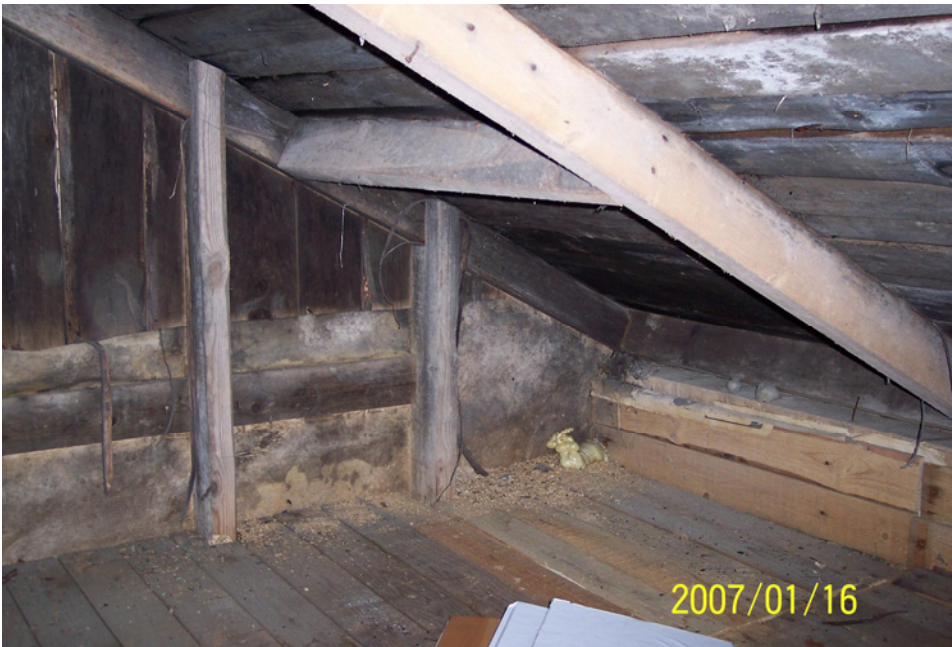
Kuva 14. Tuuletuspuutteiden aiheuttamia yläpohjavaurioita
