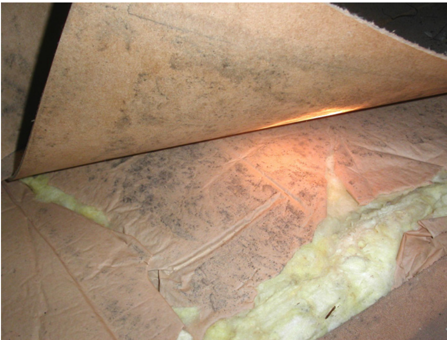
Kuva 12. Tiivis levy lämmöneristeen päällä on aiheuttanut vaurioita
