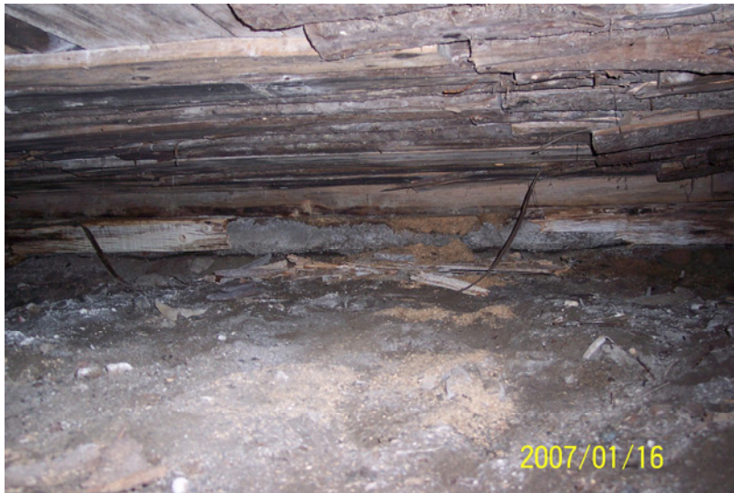
Kuva 1. Pahasti vaurioitunutta rossipohjaa
