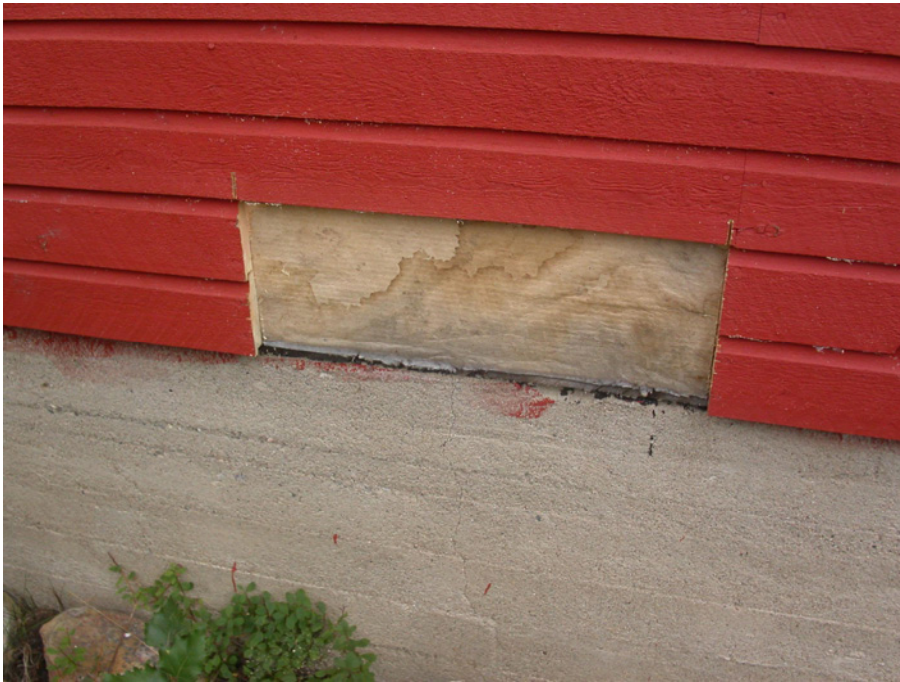
Kuva 9. Julkisivulaudoituksen takaa puuttuu tuuletusrako
