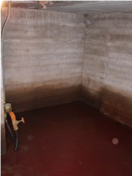
Kuva 3. Vettä kellarin lattialla
