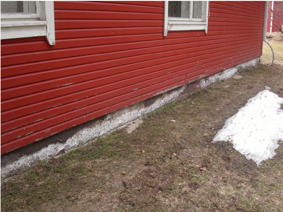
Kuva 8. Maaperästä nouseva kosteus vaurioittaa perustuksia
