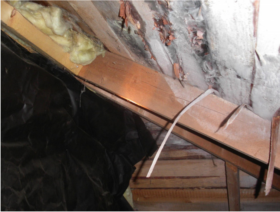
Kuva 13. Vanhan vesikattovuodon aiheuttamia homevaurioita, tuuletusraot tukittu
