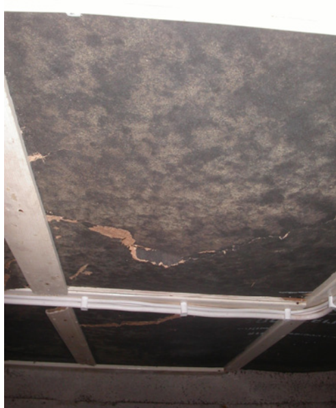
Kuva 4. Homehtunutta kellarin kattolevyä
