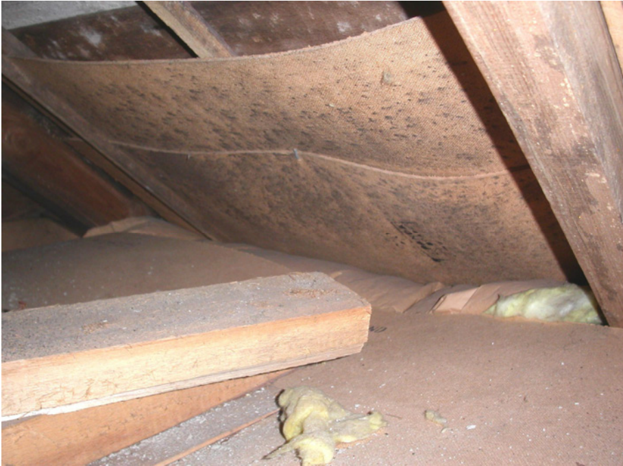
Kuva 11. Puutteellisen tuuletuksen aiheuttamia yläpohjavaurioita
