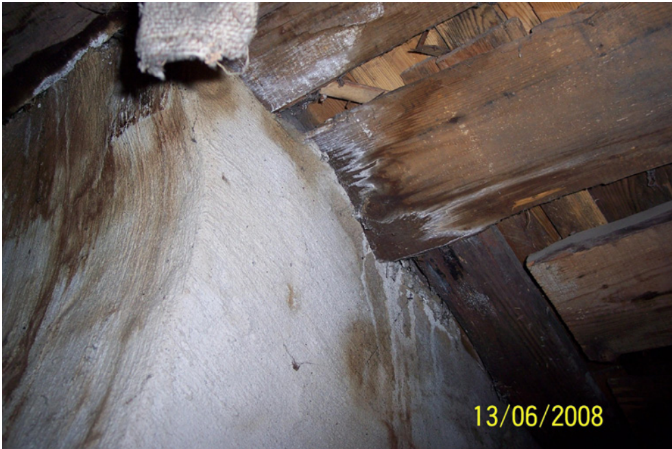
Kuva 15. Savuhormin juuren vuodon aiheuttamia vaurioita
