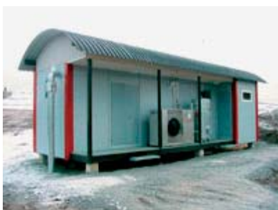
Heinälamminrinteen kaatopaikan pumppaamo.
