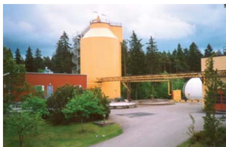
Forssan vesihuoltolaitoksen biokaasulaitos.
