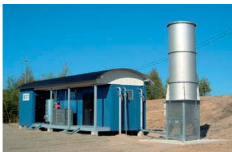
Rovaniemen Mäntyvaaran pumppaamo.
