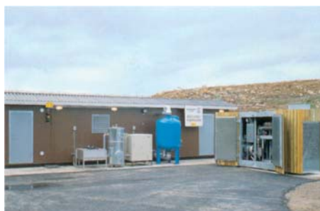
Kiertokapulan Hyvinkään pumppaamo.
