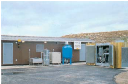
Kiertokapulan Hyvinkään pumppaamo.
