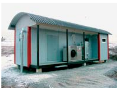
Heinälamminrinteen kaatopaikan pumppaamo.
