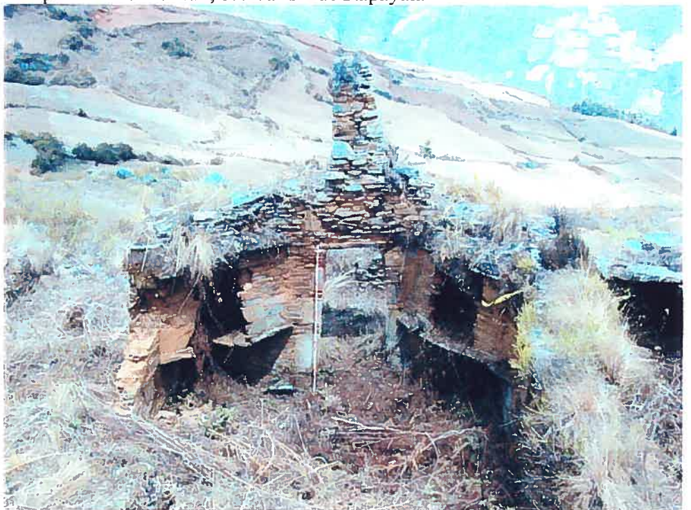
Photo 26. Vue de haut de la façade interne d'une habitation flanquée de deux corniches dans ses coins supérieurs. Les toits constitués de dalle en encorbellement demeurent intacts, alors que les pierres verticales scellant les cavités ont disparu. Notez le « toit » en forme de pointe, secteur I de Rapayan.
