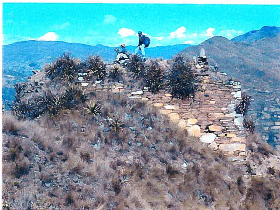
Photo 104. Vue de la façade arrière (nord) de l'édifice à deux niveaux du secteur II , site # 38 (Hijin II) d'Hijin.
