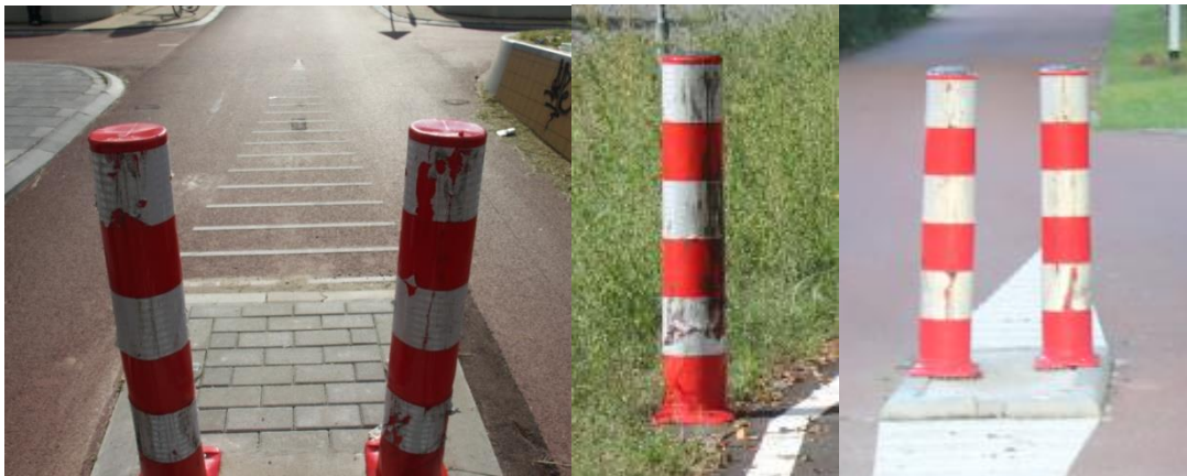
Figuur 22: De beschadigde paaltjes in Barneveld (links), Hardenberg (midden) en Houten (rechts).
