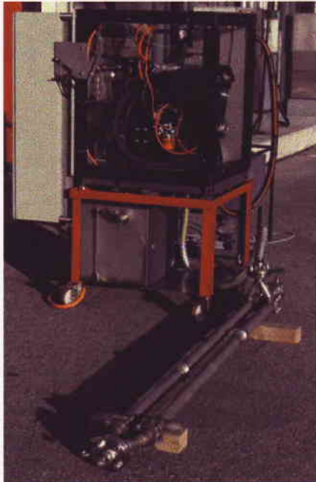
Fig.4.2 : Unité moteur de Cogénération
