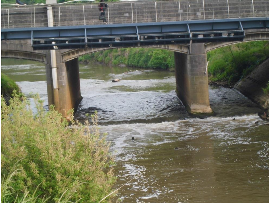
Figuur 3 Zicht op de brug van Diest bij het basisdebiet van 5,73 \text{ m}^3/\text{s} . Onderaan zijn de contouren van de bodemplaat zichtbaar.
