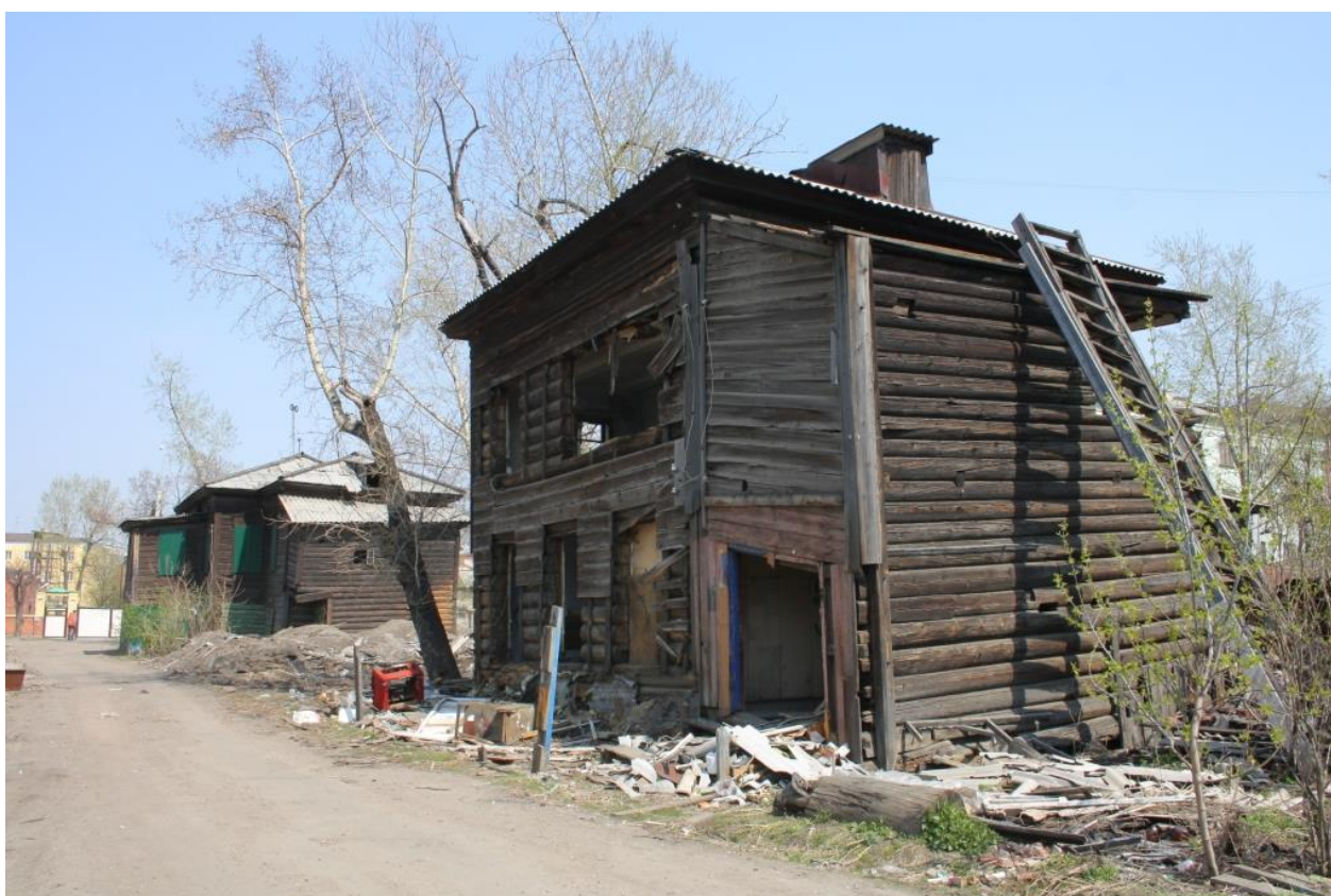
Рис. 1. Состояние деревянной застройки в г. Иркутске, переулок Черемховский, 2011
