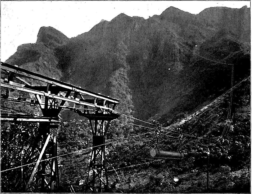
Abb. 33. Ansicht der Bahnanlage von der 900 m Spannweite an bis zur Winkelstation I.
