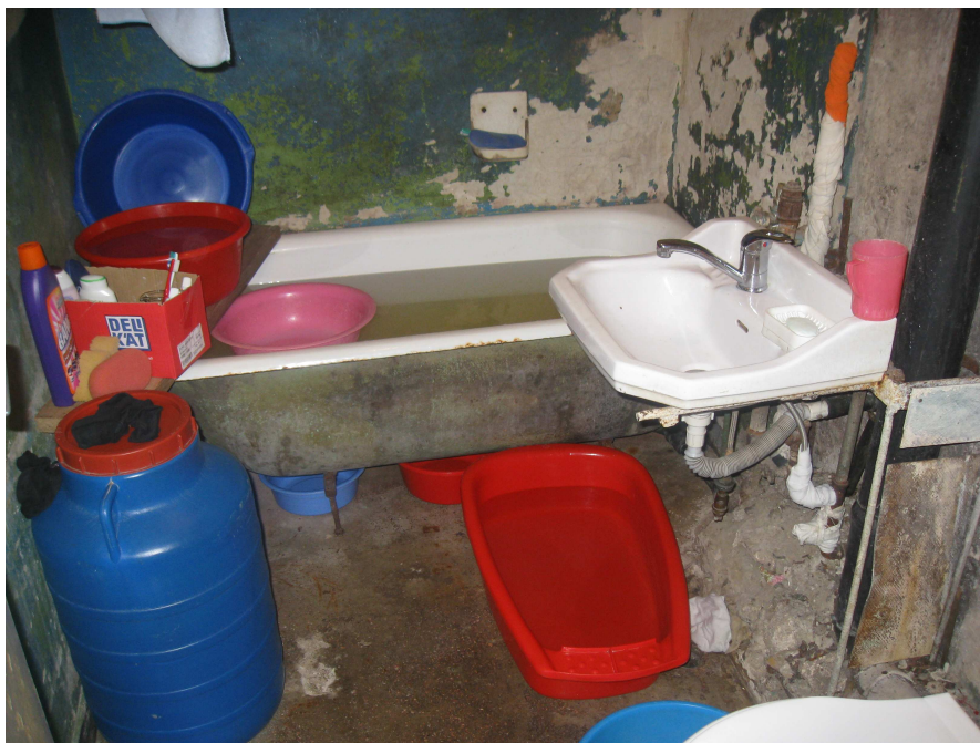
Abbildung 17: Sanitäre Anlage in einer Wohnung (Quelle: Foto, Sarah Jörg, 2009)
