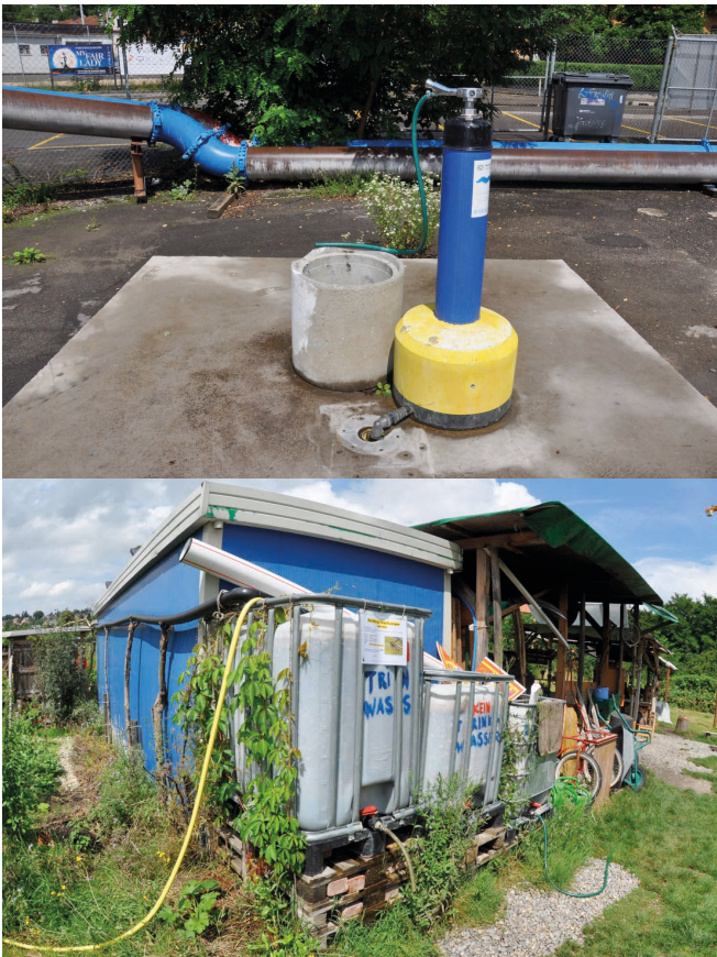
Abb. 16: Trinkwasseranschluss der Stadionbrache und Wassertanks
