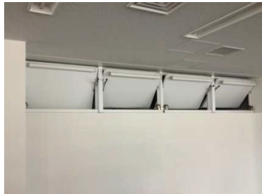
図 4-4 吹き抜け排気口
