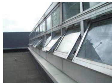
図 4-5 外部への排気口
