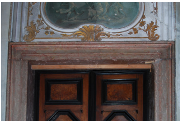
Image 88: Door jamb detached
