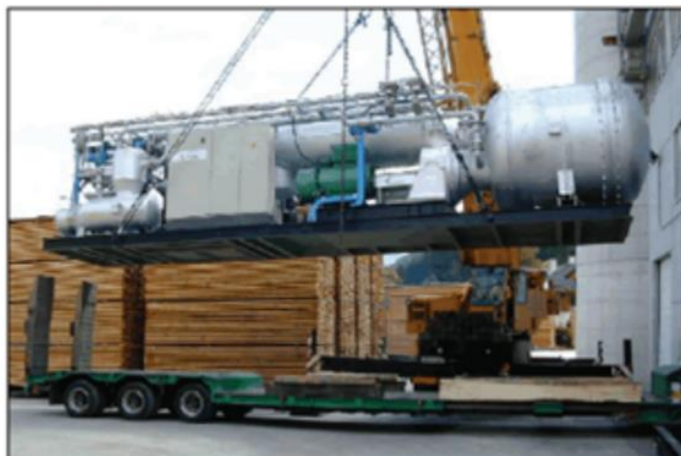
Figura 3.22 – Unidade baseada no COR, de 450 kWe, durante a instalação, em Admont, Áustria [49]
