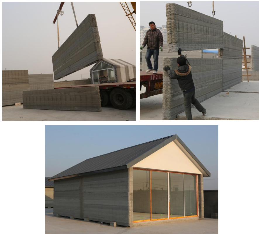
Figura 60 – Sequência de montagem até à obtenção de uma das dez casas construídas pela empresa em 24h [96]
