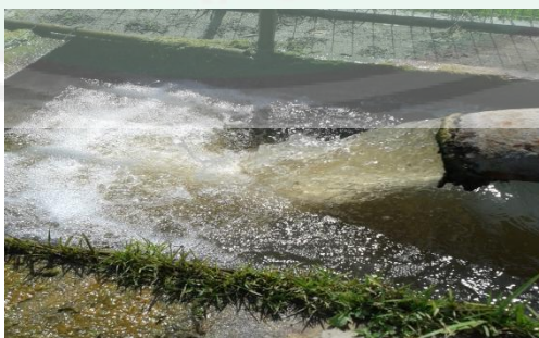
Gambar 4.1 Bak penampung pertama Water Treatment air Sungai Bengawan Solo Pusdiklat Migas Cepu
