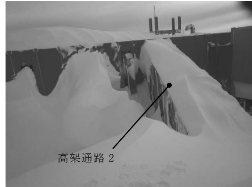
写真Ⅲ.6.2.3-2 4月22～24日のB級 ブリザード後の高架通路2 (汚水処理棟屋根から撮影)
