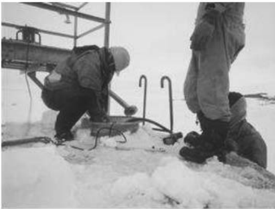
電動ポンプによるタンク内に残った燃料の移送
