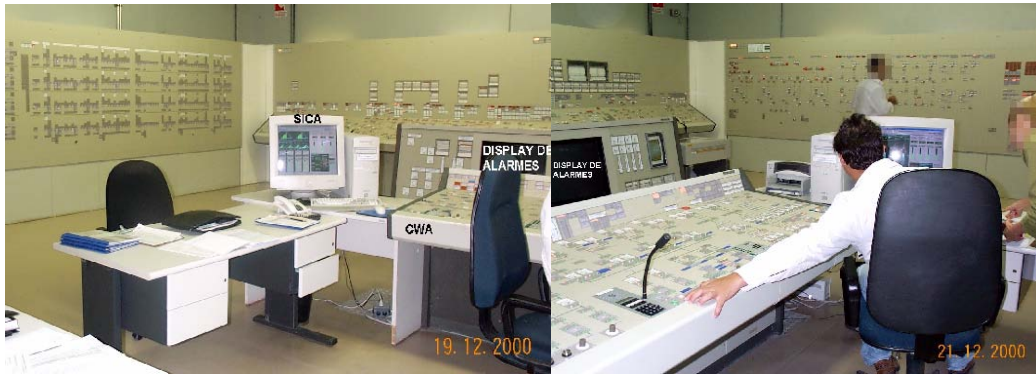
Figura 5.5 Postos de trabalho dos Operadores do Reator e Secundário.
