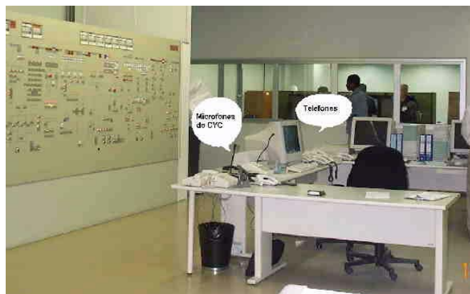
Figura 5.13 Mesa de comunicação da sala de controle.
