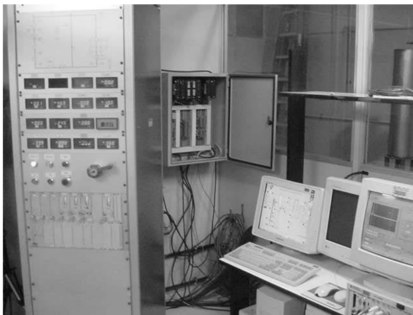
Figura 3.9: Sistema de controle e aquisição de dados - rack e equipamento Fieldbus.
