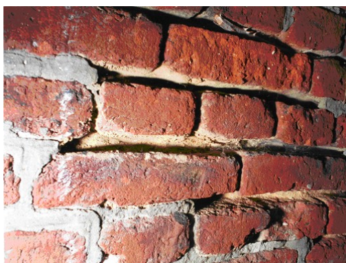
Figure 1-13 Disjointoiement profond sur une maçonnerie de briques [IN 2086, 2007].
