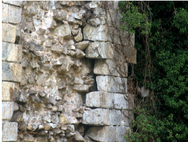
Figure 1-15 Dislocation d'un ouvrage de pierre [IN 2086, 2007].
