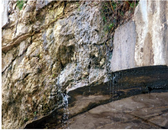
Figure 1-12 Les défauts d'étanchéité sont caractérisés par des coulures d'eau.
