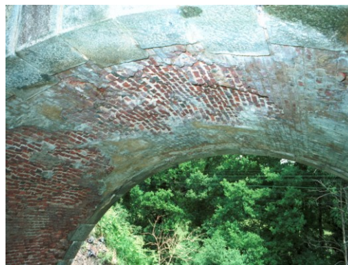
Figure 1-14 Épaufrement d'une grande partie de l'intrados d'une voûte en maçonnerie de brique [IN 2086, 2007].
