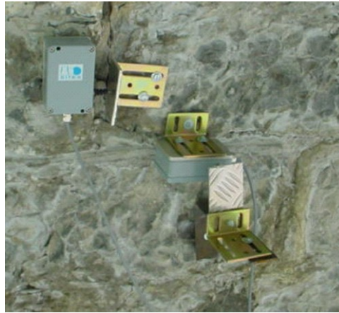
Figure 1-22 Couplage de fissuromètres pour un suivi tri dimensionnel [IN 2086, 2007].
