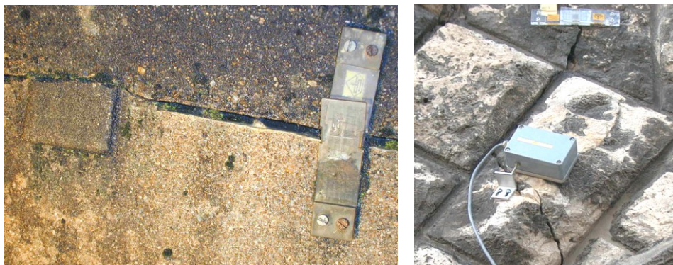
Figure 1-21 Trois époques, trois technologies, trois types de suivi des fissures [IN 2086, 2007].
