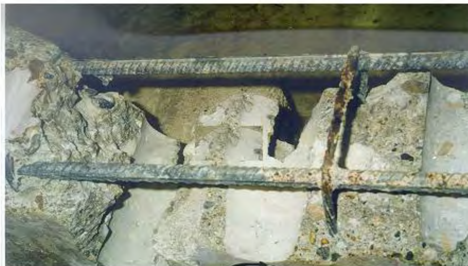
Figure I-17 : Etat de corrosion des armatures tendues et d'un cadre d'effort tranchant d'une poutre B1 après 14 ans en milieu salin
