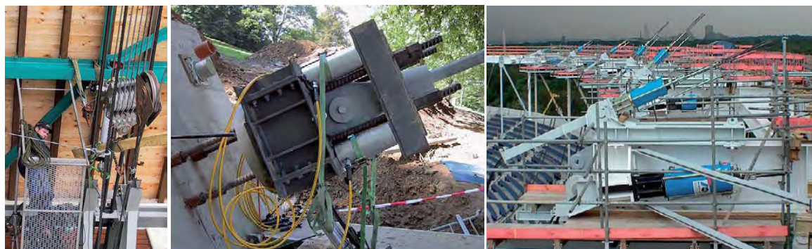
Slika 81: Levo: Električno vitlo s sistemom škripcev za natezanje kablov; Sredina: Natezanje in priključevanje stabilizacijskih kablov na temelj s hidravličnimi cilindri; Desno: Natezne naprave za dviganje in natezanje kablov (Seidel, 2009)
