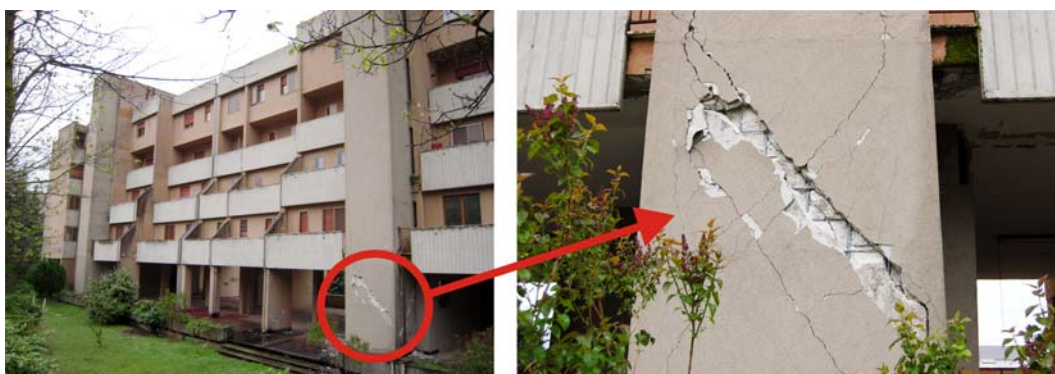
Slika 9.1: Porušitev konstrukcijskih sten med potresom L'Aquila 2009. Foto.: M. Rozman in K. Rejec, 2009 Figure 9.1: Failure of a structural wall during the 2009 L'Aquila earthquake. Phot. by M. Rozman and K. Rejec, 2009
