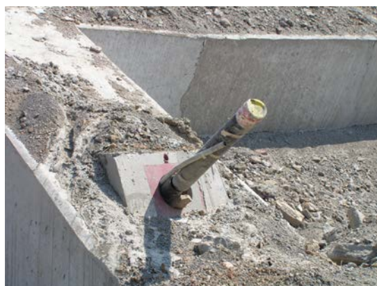
Slika 6.32: Primer vgrajenega sidra na Z-10
