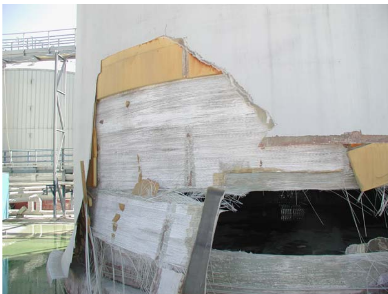
Slika 1: Poškodbe na rezervoarju iz armiranega poliestra v Luki Koper
