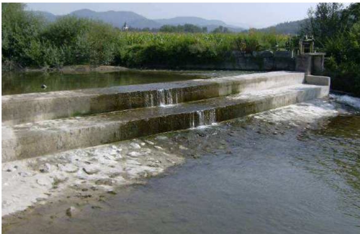
Slika 24 : Radomeljski jez z levoobrežnim odvzemom z zapornicami in talnim izpustom v času nizkega vodostaja (Bogataj, 2009)
